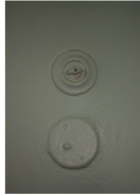
Resim 13. Etibank Binası Aydınlatma Elemanları (Mustafa Kemal Baran Arşivi, 2009).
